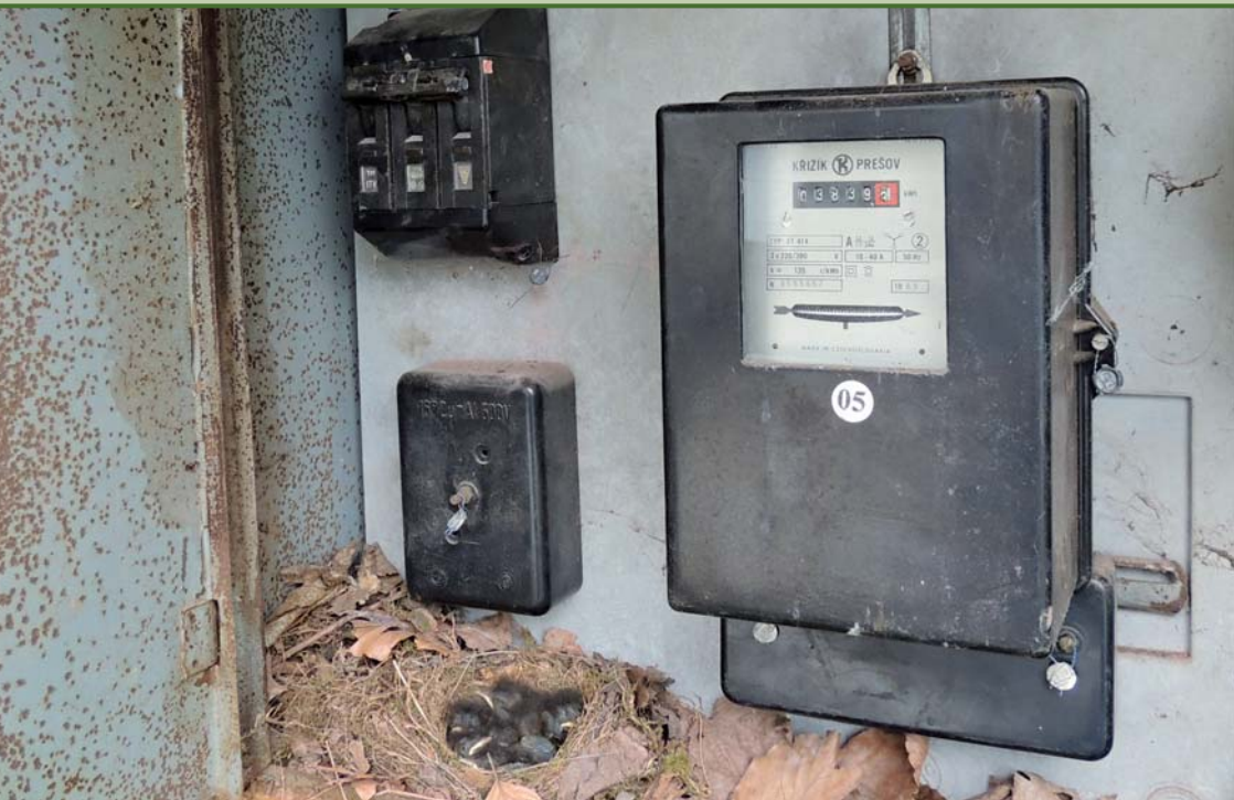
Hnízdo v elektrickém rozvaděči může být nebezpečné pro ptáky i pro člověka
