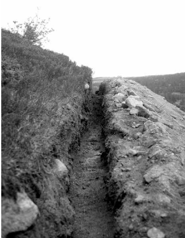
Nesprávná trasa výkopu odpadu z biologického septiku nové Labské boudy směřovala přímo do přísně chráněné Navorské jámy. Na omyl se naštěstí přišlo včas a terén se podařilo asanovat (foto Jan Štursa)
