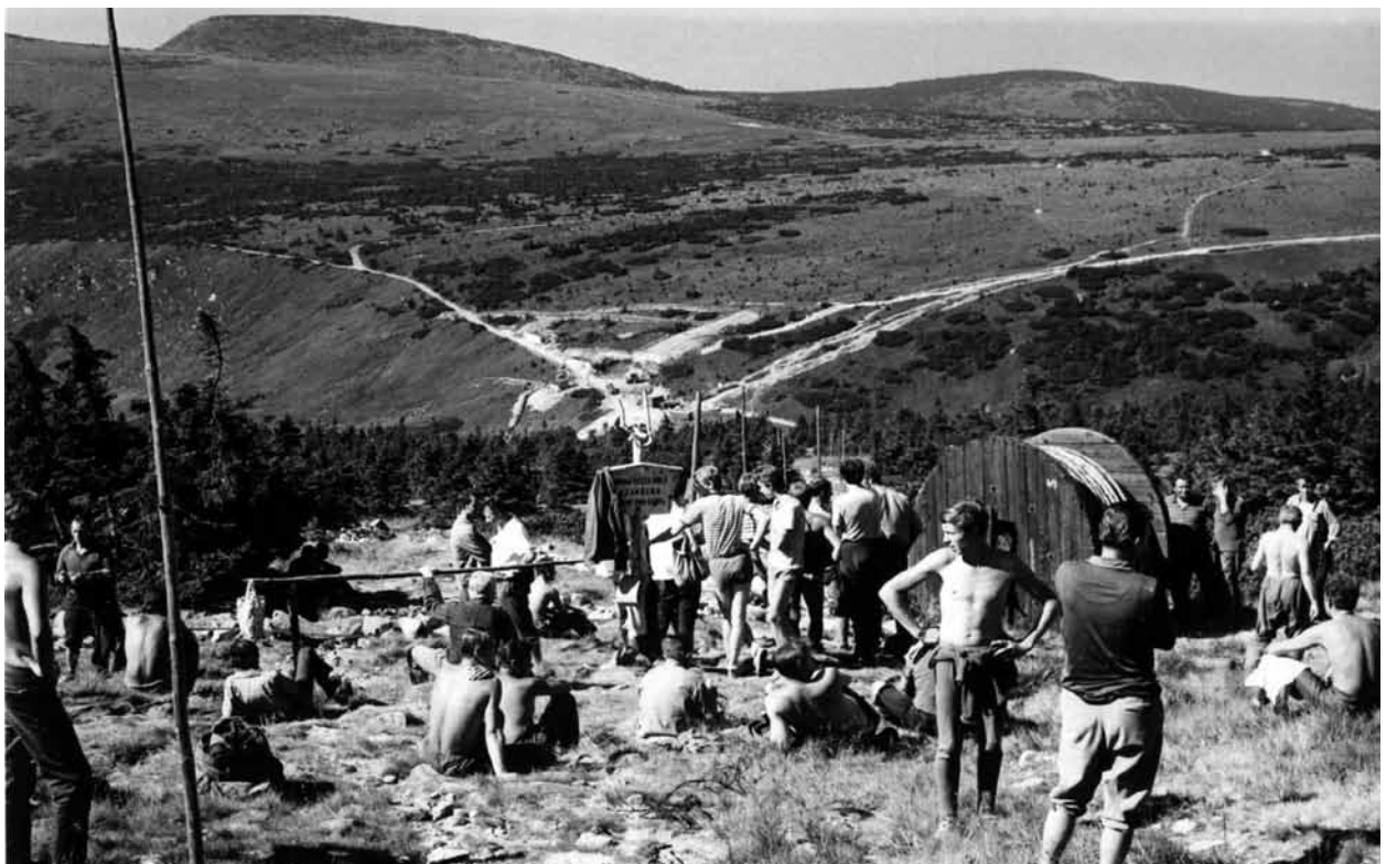
Kabelverlegung von der Labská bouda (Elbfallbaude) zur Martinovka (Martinsbaude) und zu den Schneeegruben, ca. 1969. Ähnlich wie zur Schneekoppe führen Kabel und Wasserleitung auf polnischer Seite hinauf, zu den Schneeegruben wiederum ein Kabel aus Tschechien. Die konsequente Verkabelung des Riesengebirges dauert von 1965 bis heute an. In dieser Zeit wurde nicht nur die Oberleitungen ersetzt, sondern auch nahezu sämtliche bisher nicht angeschlossenen Orte (von den großen Enklaven z.B. auch die Keilbauden) konsequent elektrifiziert. Dazu kommen noch die Linien der Fernsprechkabel. Linienbauten sind immer eine heikle Sache, deshalb werden sie mit Argusaugen überwacht (Foto Miroslav Hladík)
