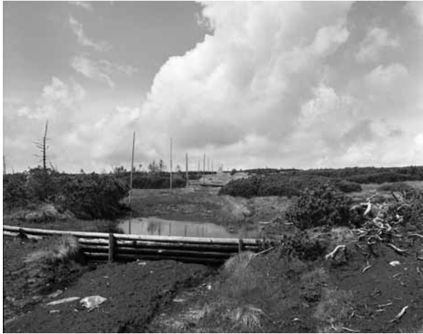
Die Holzsperrn am ehemaligen Weg von der Elbfallbaude (Labská bouda) zur Woseckerbaude (Vosecká bouda) sollen die Erosion durch Zertrampeln des sumpfigen Geländes verhindern und zur Stabilität des Wasserhaushalts im Hochmoor ‚Pančavské rašeliniště‘ beitragen (1995, Foto Karel Hník)
