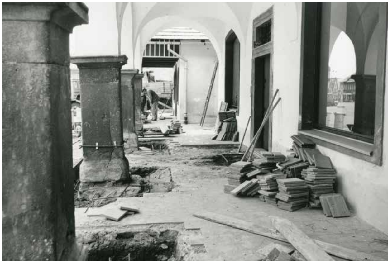
I v průběhu prací se objevovaly další problémy, které bylo třeba znovu řešit. Například statika sloupů jinak relativně nejzachovalejšího zděného středního domu čp. 223
