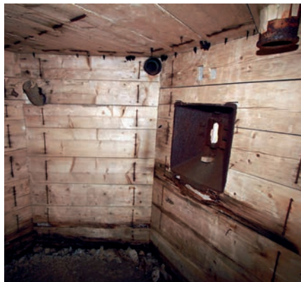
Interiér několika pevnůstek v úseku H-1 se dochoval včetně dřevěného bednění. To bylo po ukončení betonáže ponecháno na svém místě zejména za účelem ochrany osádky před úlomky betonu při nepřátelském ostřelování objektu (foto Michal Souček, 2013)
