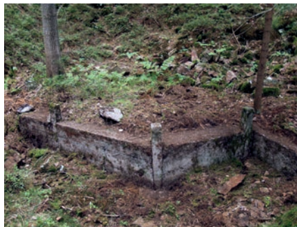
Výkop a základová deska pro objekt č. 248/E úseku H-2 s čelní palbou z druhého sledu (foto Jan Juřena, 2013)
